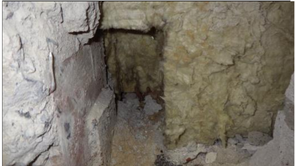
Kuva 7. Ulkoseinän rakennetutkimuskohta huoneessa 17. Mineraalivilla-eristeestä on jäänyt pala pois rakennusaikana. Vasemmalla betoni-pilari, joka on ankkuroitu sokkeli-rakenteeseen teräskiinnikkeen avulla.
