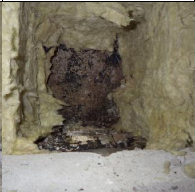
Kuva 4. Huoneen 7 rakenneavauskohdassa valesokkelin sisäpuolinen bitumieriste on vaurioitunut.
